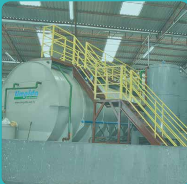
Tratamento de efluentes
